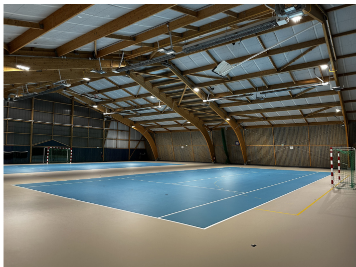
Remplacement de l'éclairage - Hall des Sports
