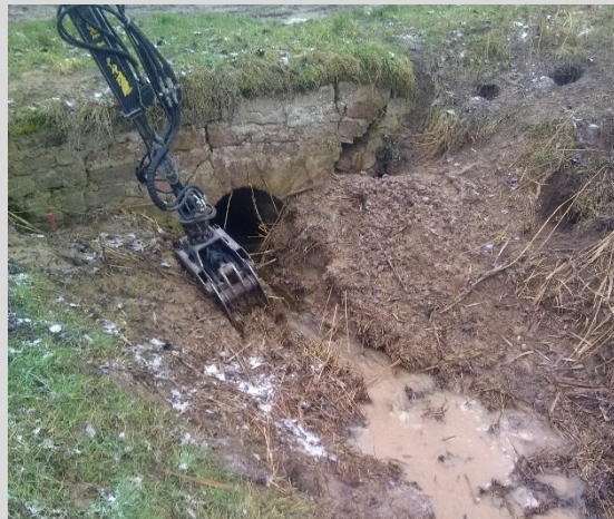
Dégagement des terres d'excavation de blaireaux sur un ouvrage du Gruft à Lipsheim
